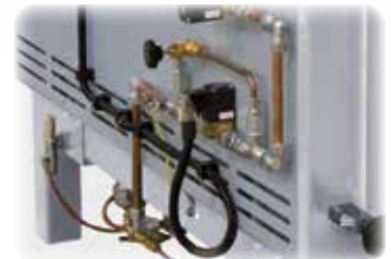
Gasleiding en thermo-element aan de voorlader
